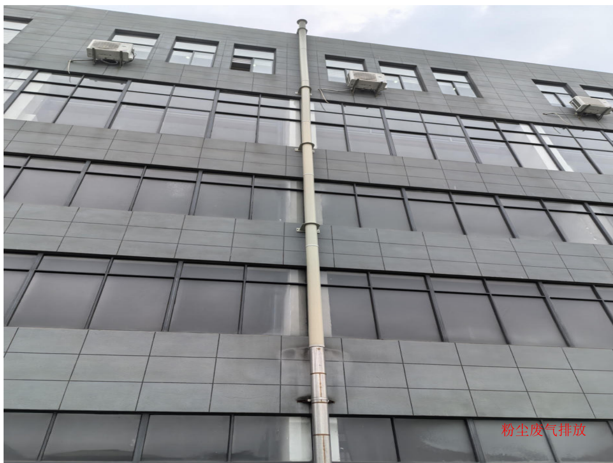
图 4-3 废气治理设施照片
