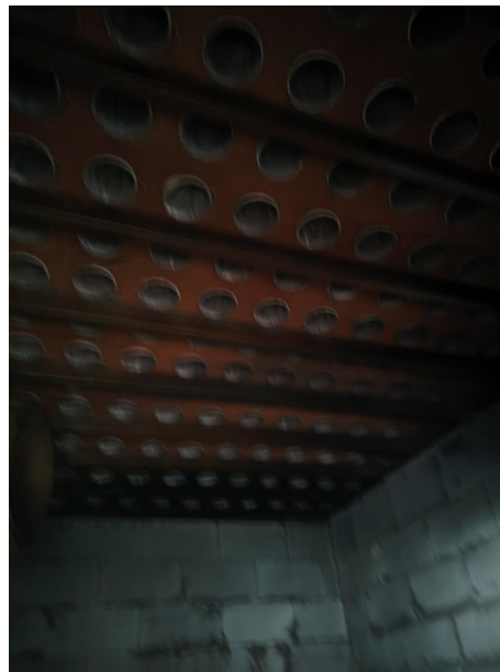
TA2002 布袋除尘装置内部照片
