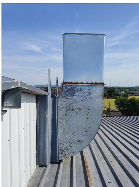
DA2001 排气筒照片
