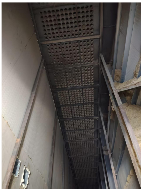
TA2001 布袋除尘装置内部照片
