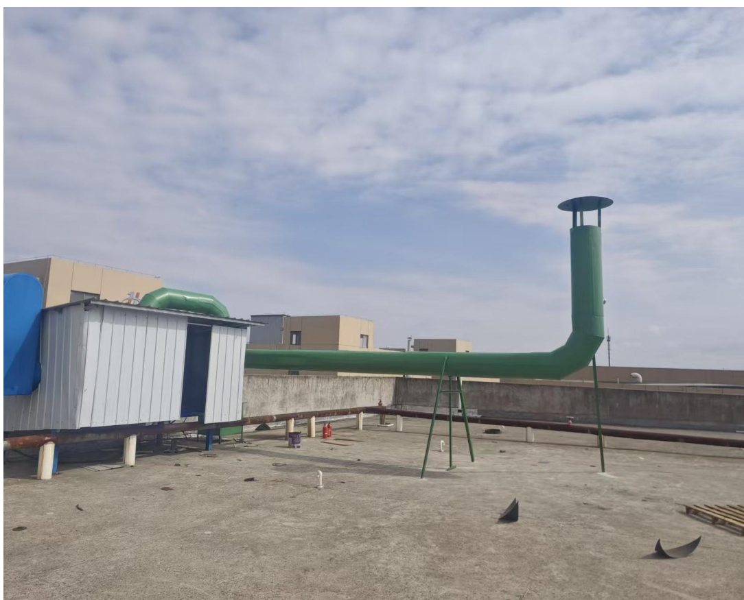
废气处理设施
