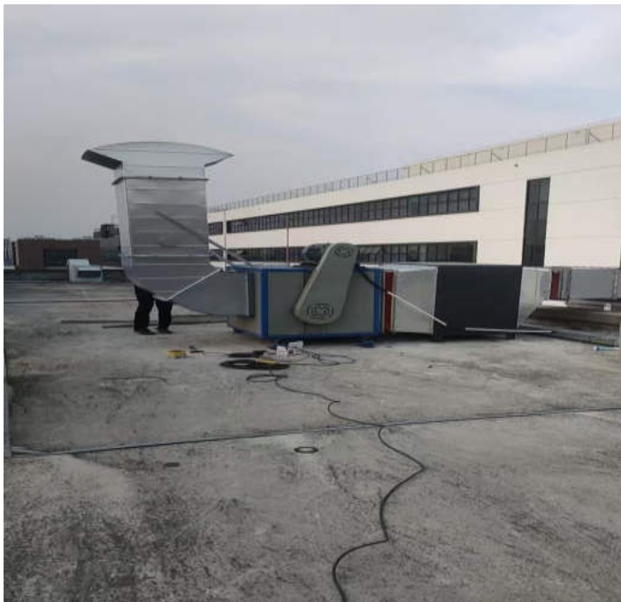
图 4-4 废气治理设施照片
