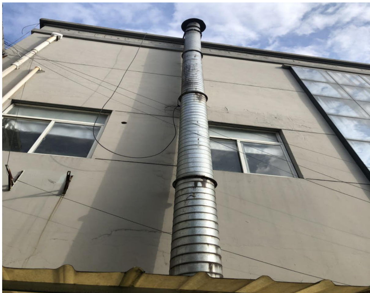
图 4-3 1号车间废气治理设施照片
