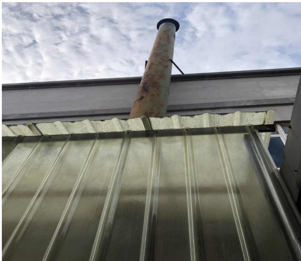
图 4-4 2 号车间废气治理设施照片
