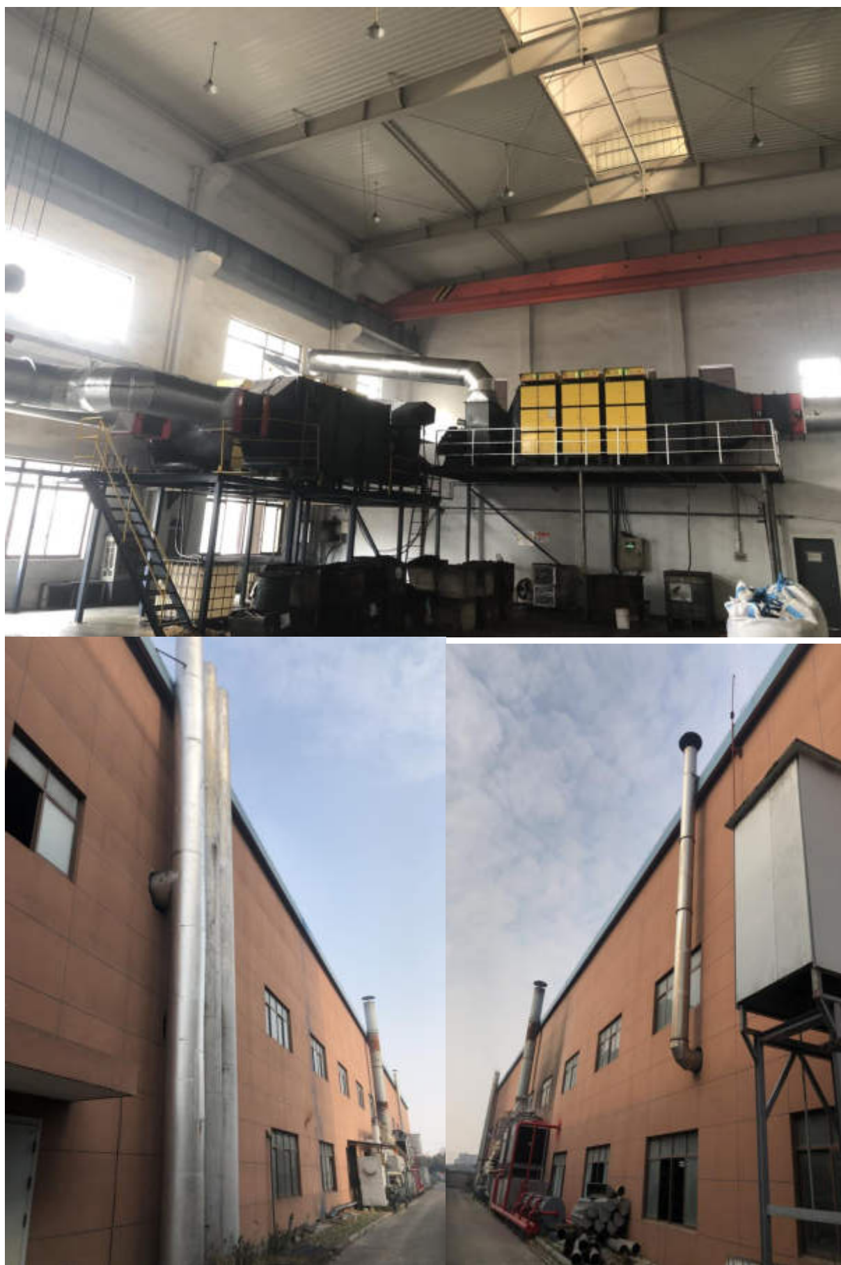
图 4-3 废气治理设施照片
