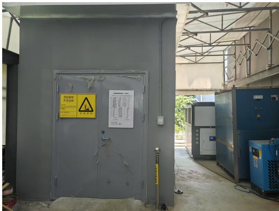
危险废物仓库
