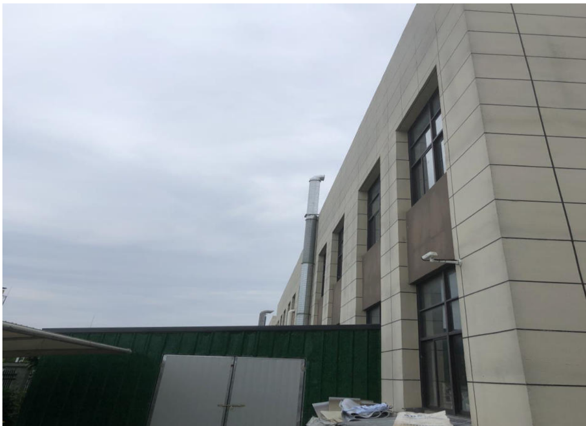
图 4-3 有机废气废气治理设施照片
