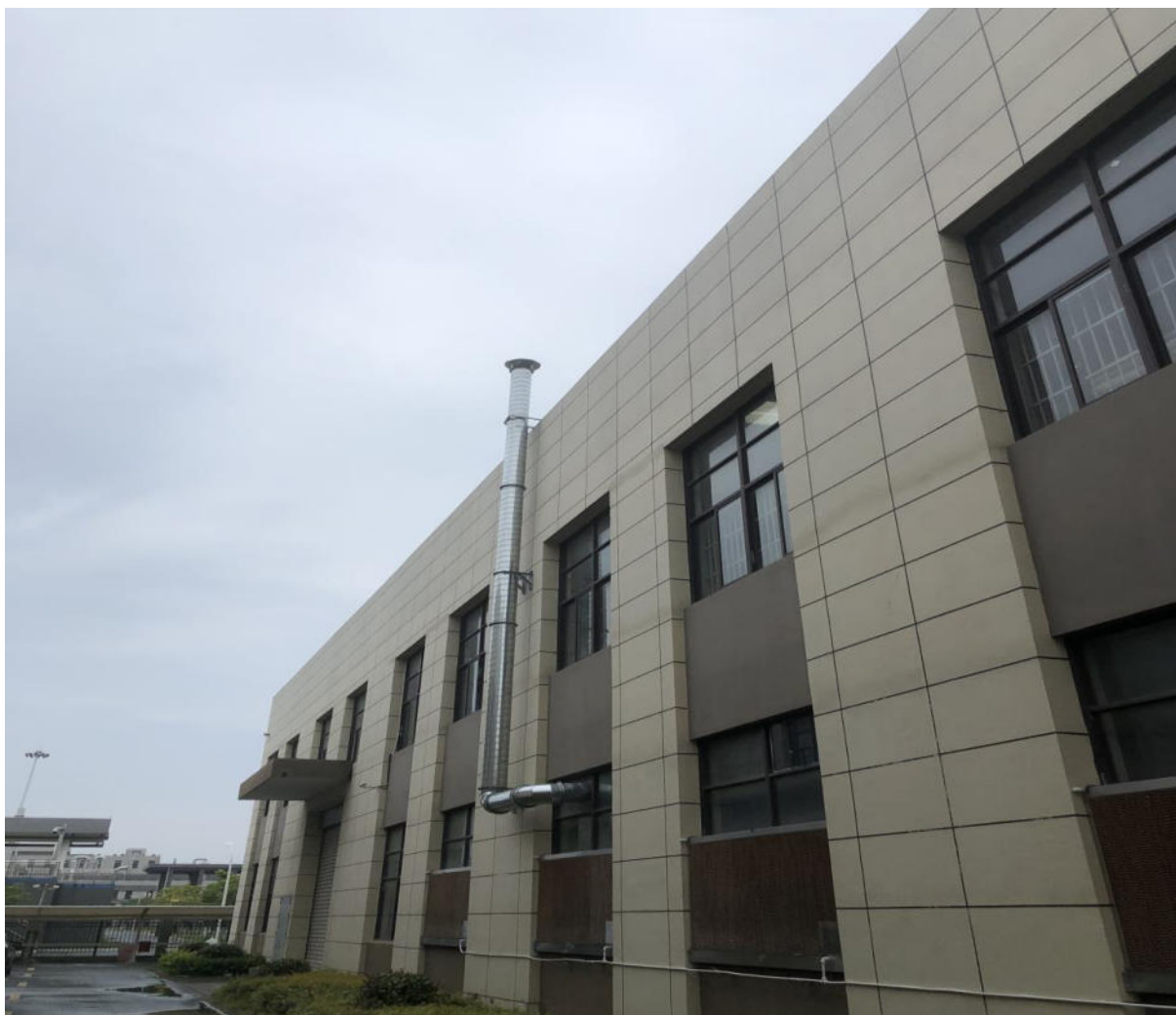
图 4-4 粉尘废气废气治理设施照片
