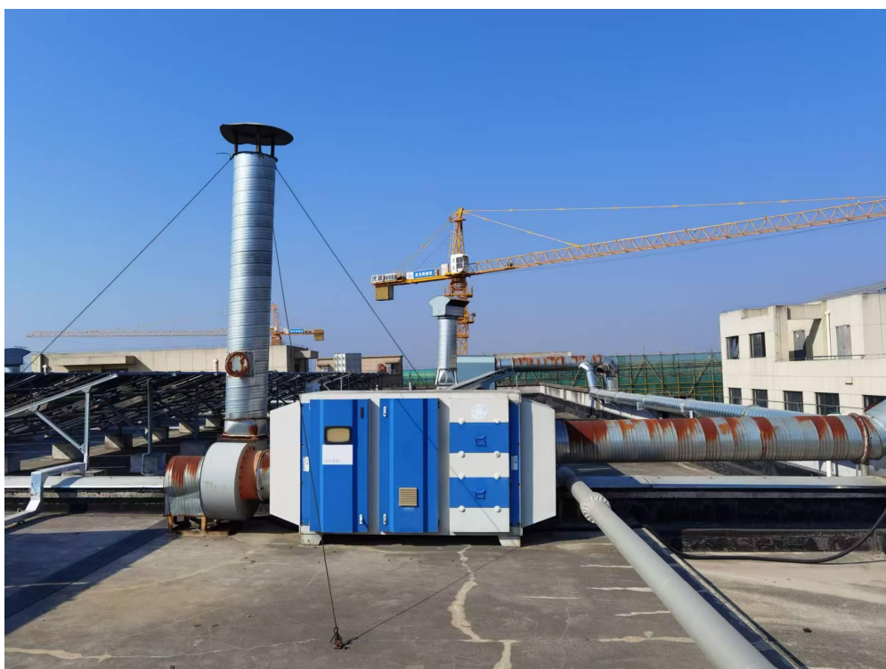
废气处理设施照片
