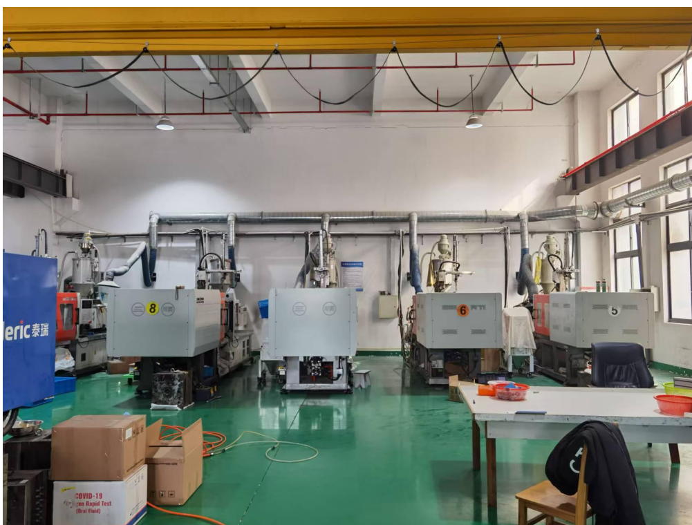
废气收集设施照片
