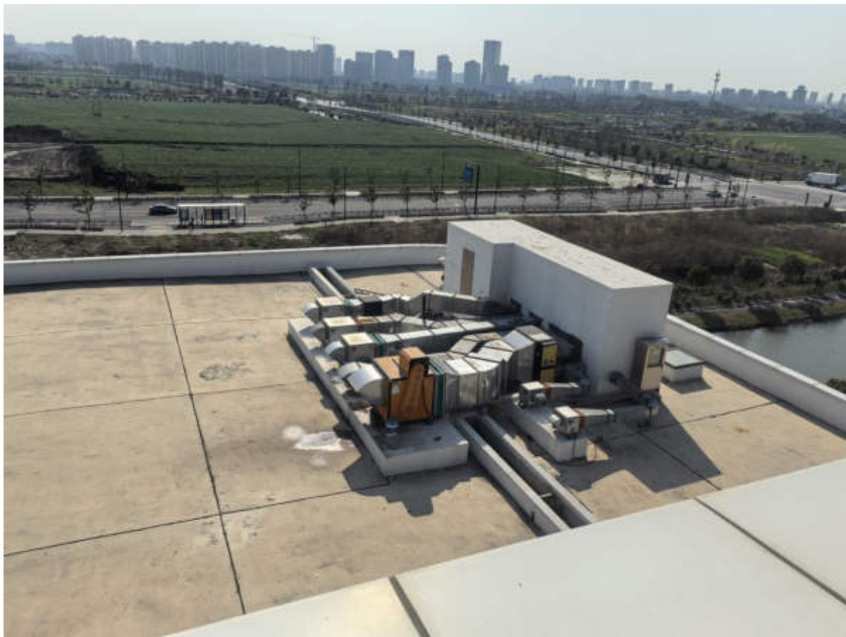
图 4-4 废气治理设施照片
