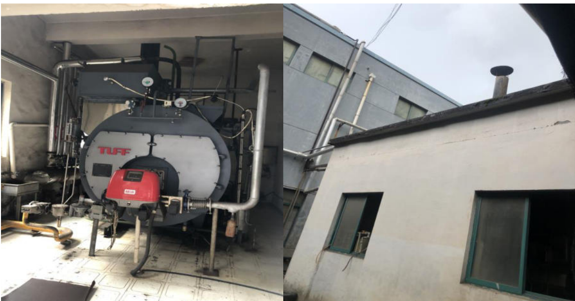
图 4-5 锅炉（天然气燃烧废气）治理设施照片
