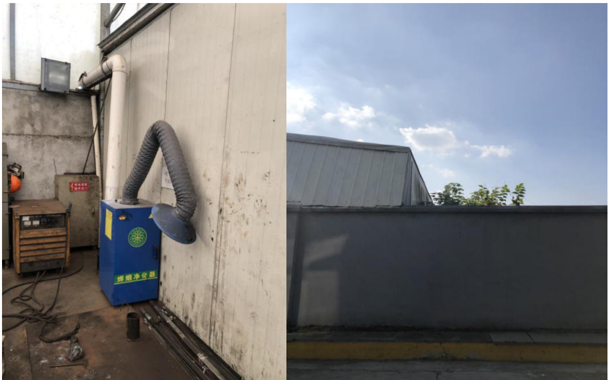
图 4-7 焊接废气治理设施照片
