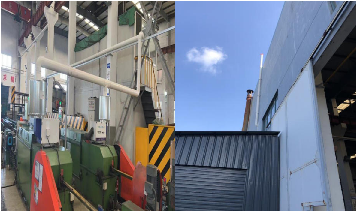
图 4-9 冷轧废气治理设施照片
