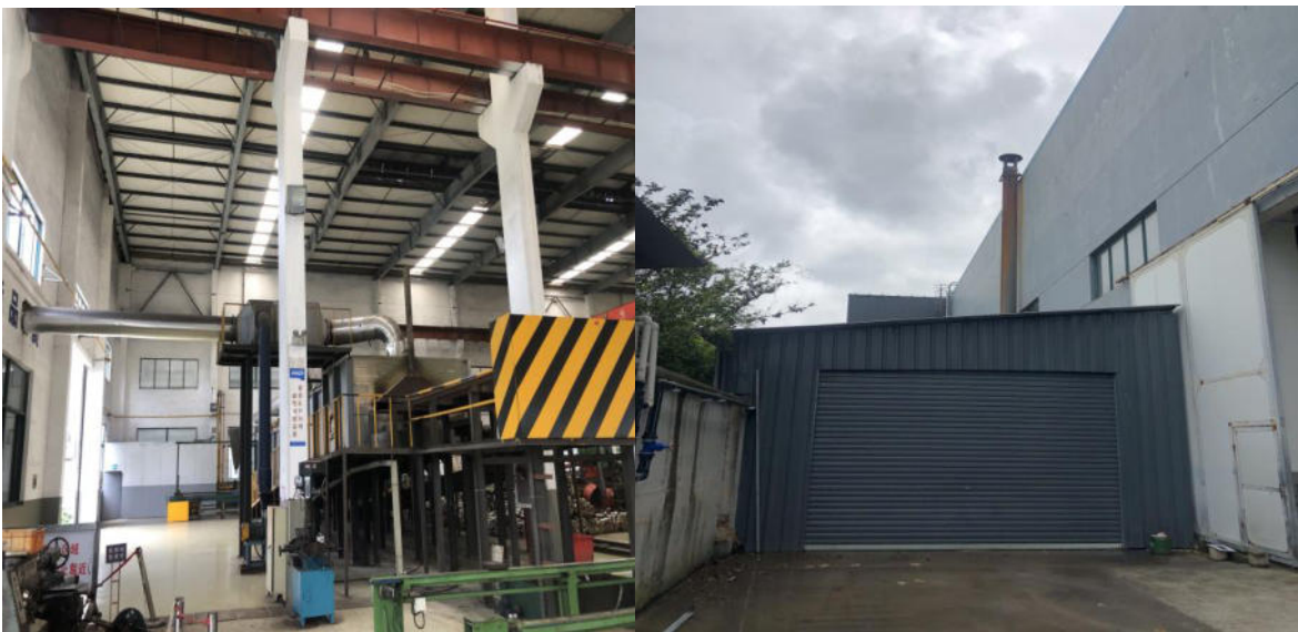
图 4-4 穿孔（天然气燃烧废气）治理设施照片
