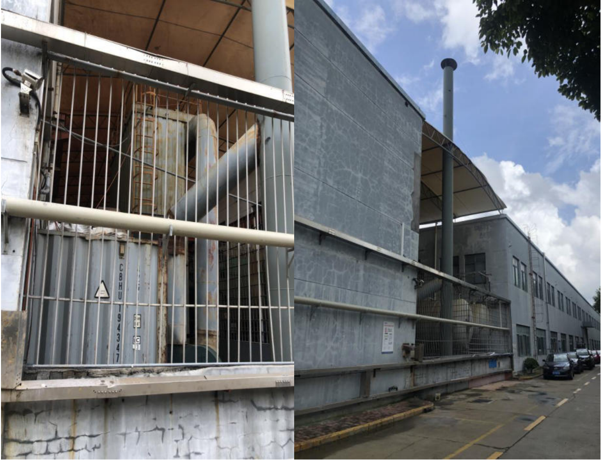
图 4-8 修磨、喷砂废气治理设施照片
