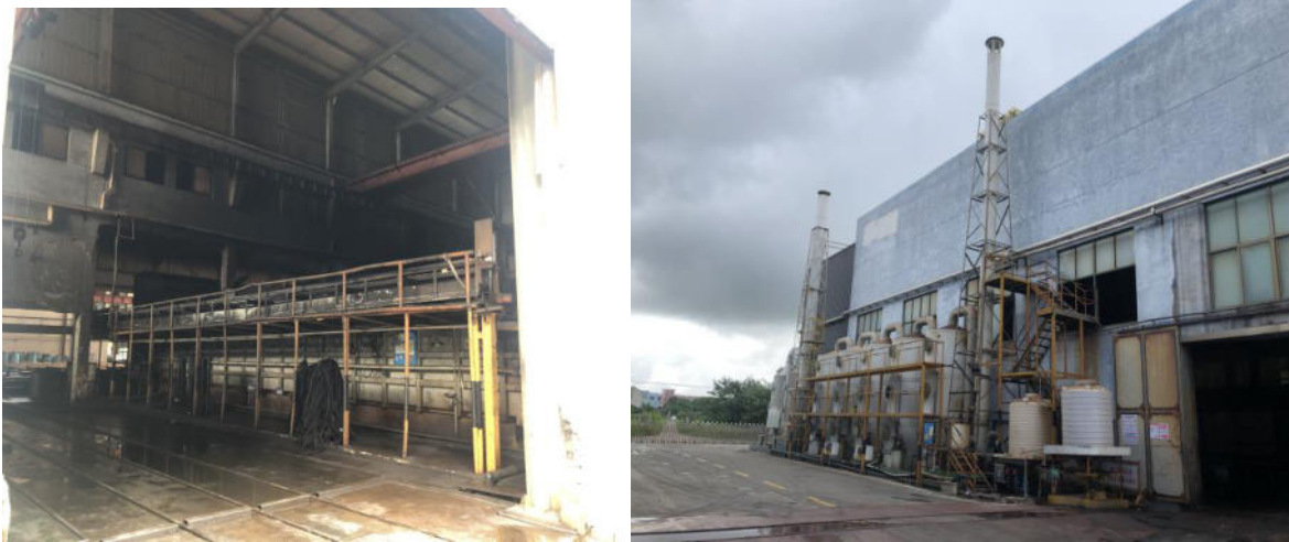
图 4-3 酸雾废气治理设施照片
