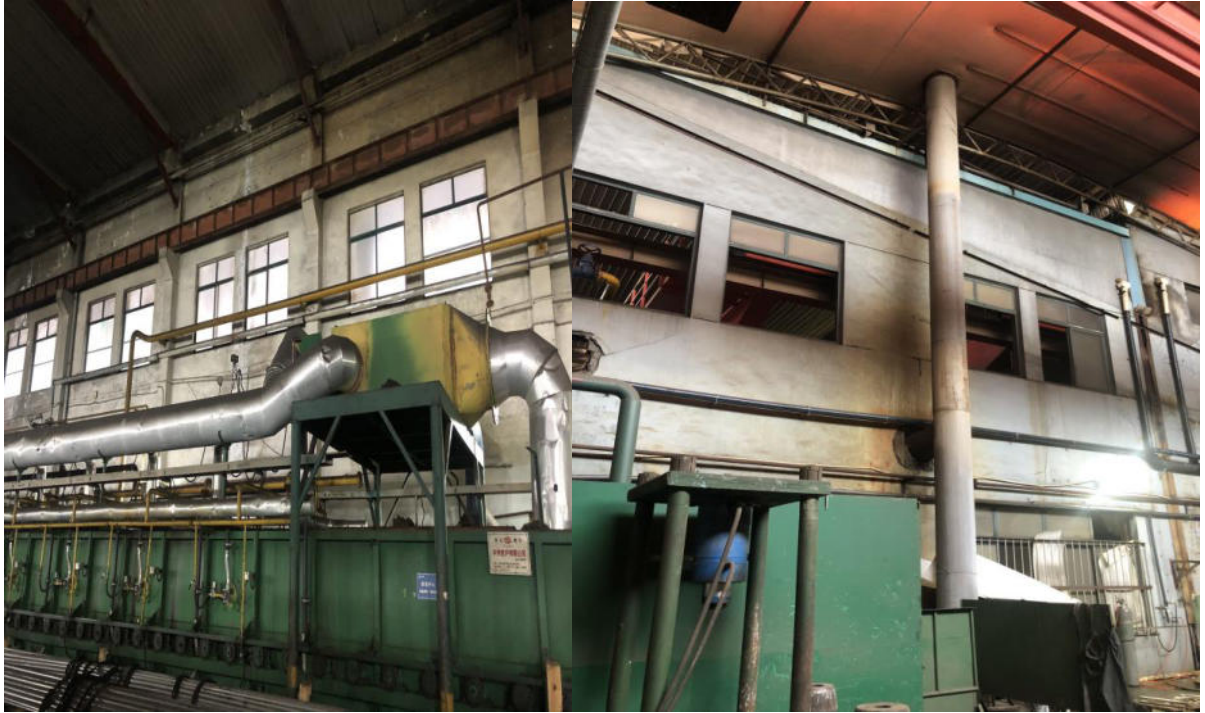
图 4-6 退火（天然气燃烧废气）治理设施照片
