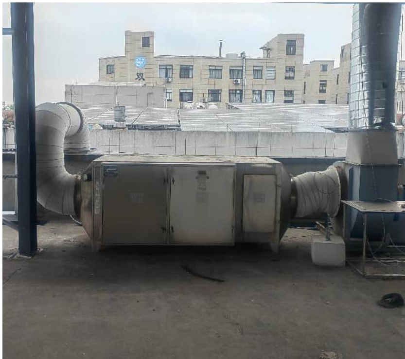
废气处理设施
