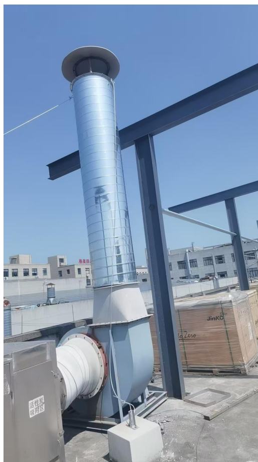
废气处理设施出口
