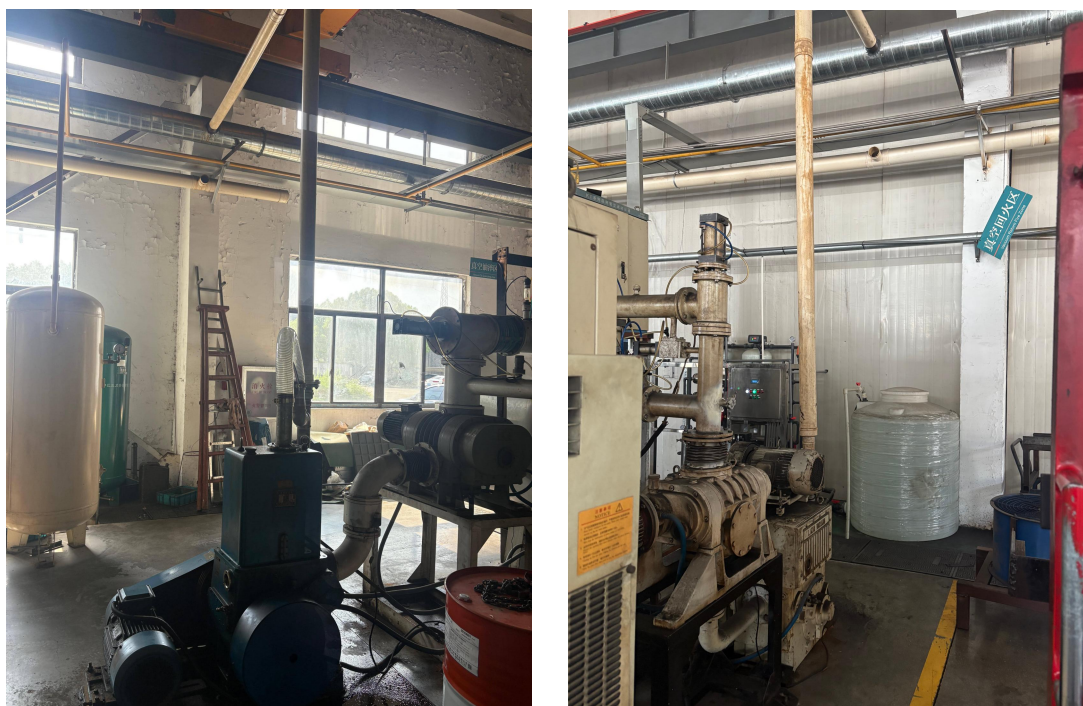
图 3-6 废气收集现场情况图
