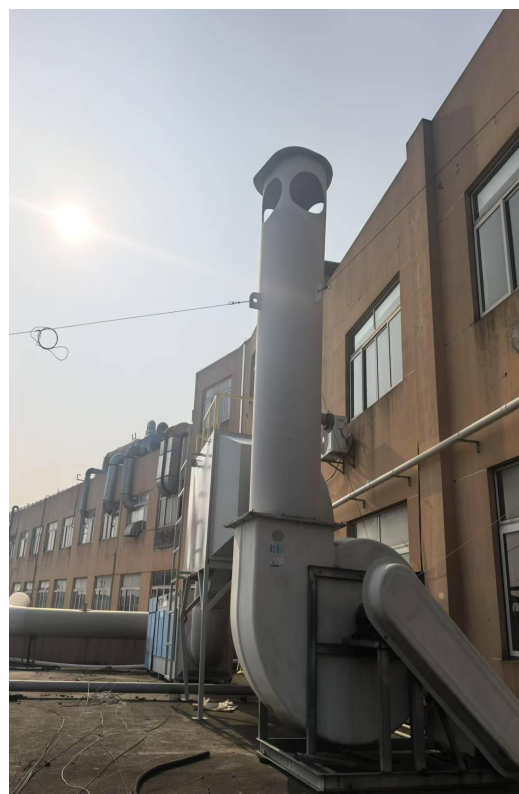
南侧 TA002 活性炭吸附装置
