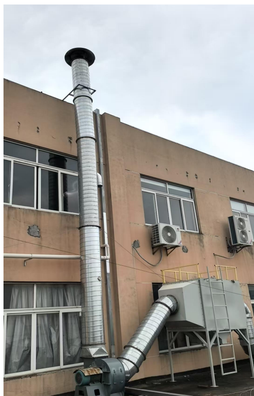
北侧 TA001 活性炭吸附装置
