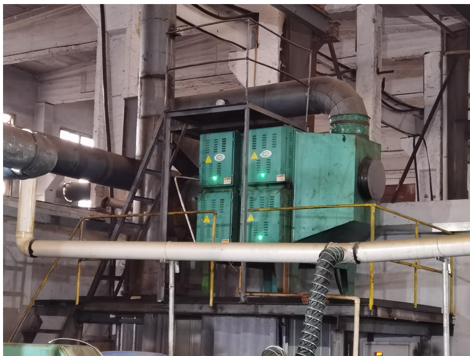
废气处理设施照片
