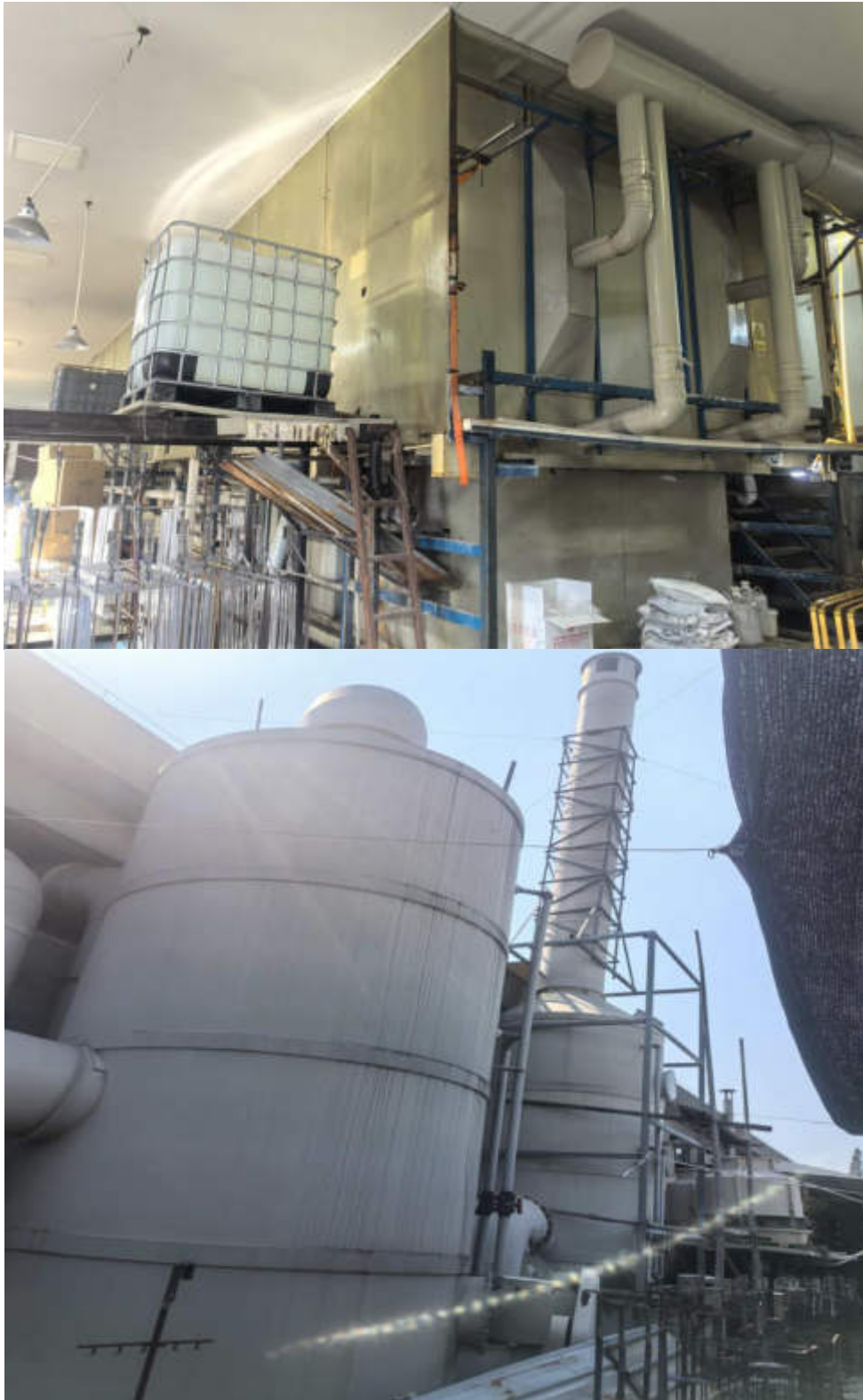
图 4-3 废气治理设施照片
