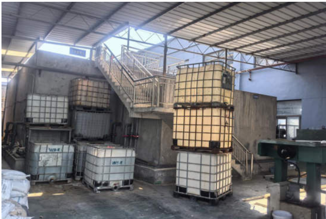
图 4-2 废水治理设施照片
